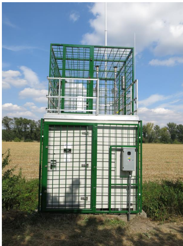
Obr. 11 AMS Věřňovice, ceilometr umístěn v kleci na střeše stanice
